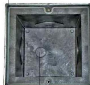
Místo možného vylomení ve dně šachty pro odtok vody
